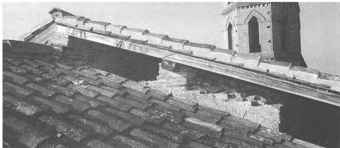
Clocher-mur vu de l'extérieur au moment du déblayage au-dessus de l'abside (voir revue n° 7) Photo Thomas Alonzo
