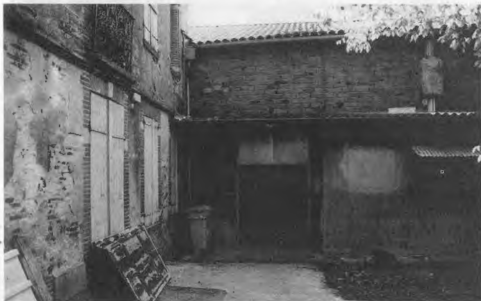
Les portes «à plusieurs vantaux» servant de «sorties de secours» dans leur état actuel. (Photothèque municipale)
