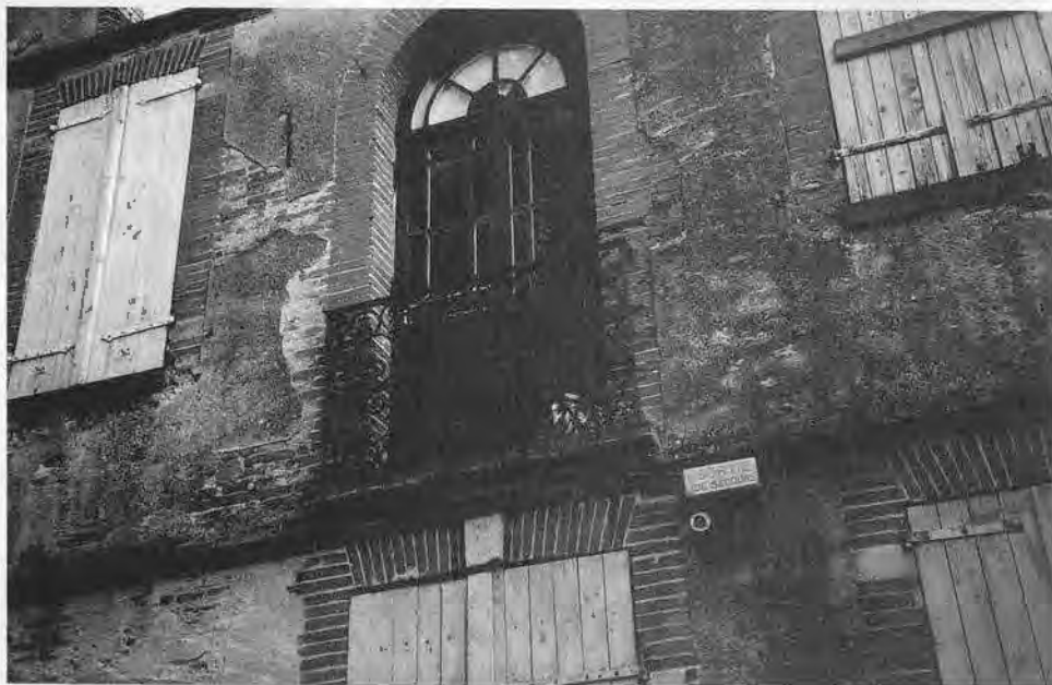
«Sortie de secours» sur la maison incendiée. (coll. personnelle)
