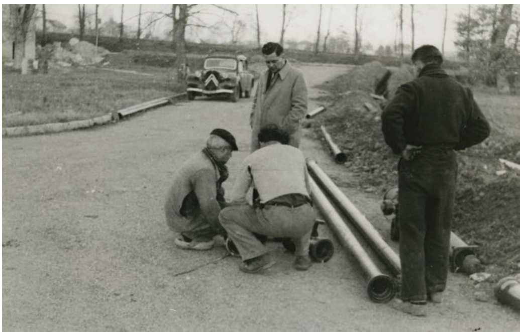
Pose de canalisations dans le Ramier par les employés municipaux en présence du maire Jean-Louis Puig (collection : famille Ricard)
